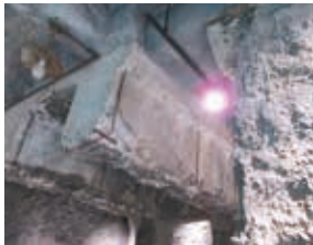
空襲後、日本石油秋田製油所で唯一残った溶けたコンクリートの柱
